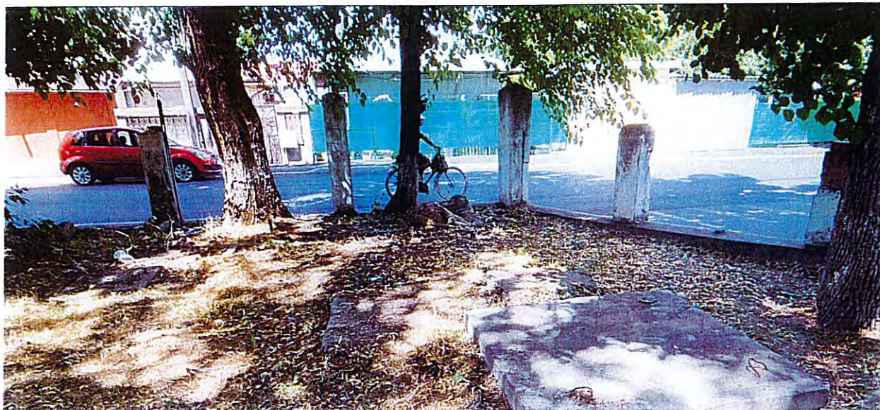
Panouri de plasa lipsa
