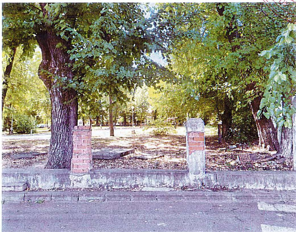
Deteriorari ale stapilor
