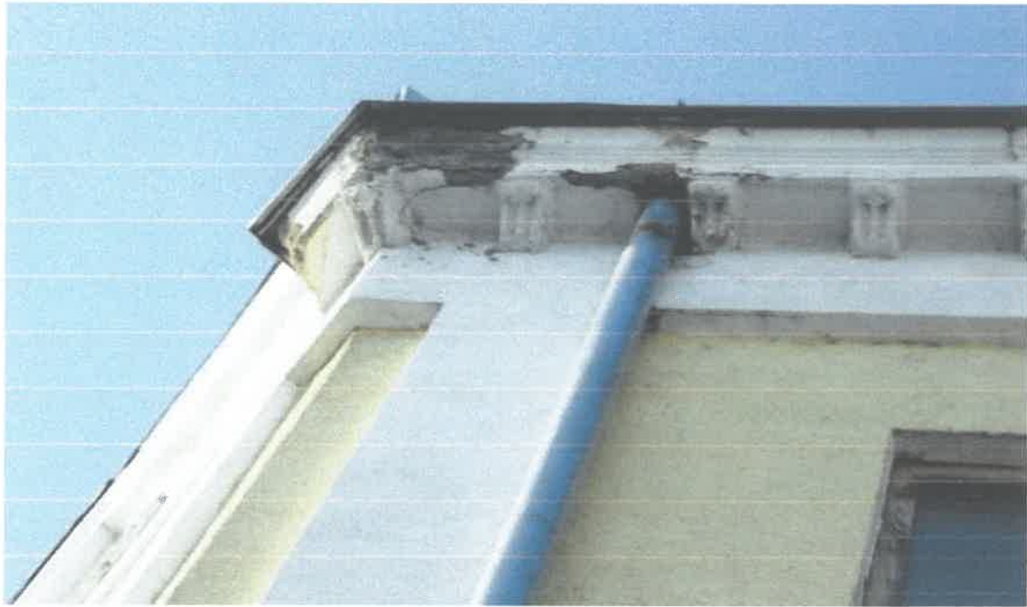
Figura 13 – Fațadă – degradarea tencuielii exterioare (corp C1)
