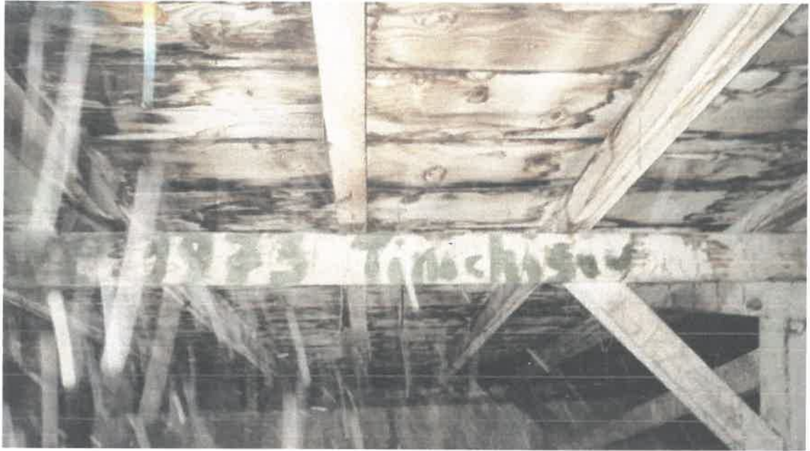
Figura 15 – Degradări ale elementelor din lemn (corp C1)
