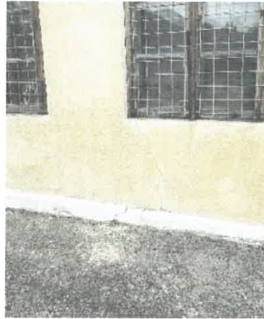
Figura – Fisuri la colțul ferestrelor
