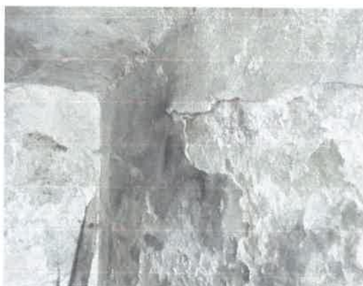
Figura 21 – Pereți afectați de umiditate
