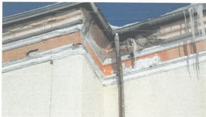
Figura 19 – Fațadă – degradarea tencuielii exterioare
