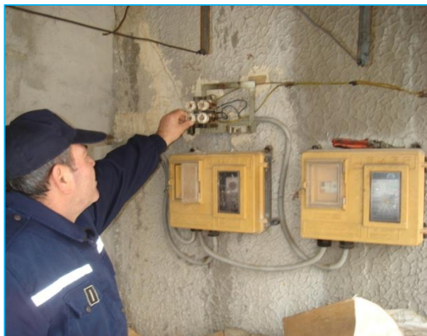
Foto 91 - Controlul tablourilor electrice
