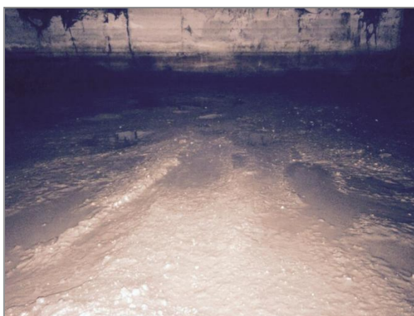
Foto 53 - subsol înainte de igienizare
