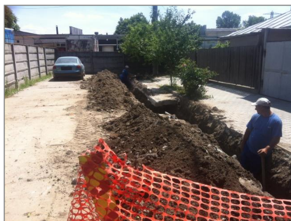
Foto 55 - Branșament S.C. Apa Service S.A.
